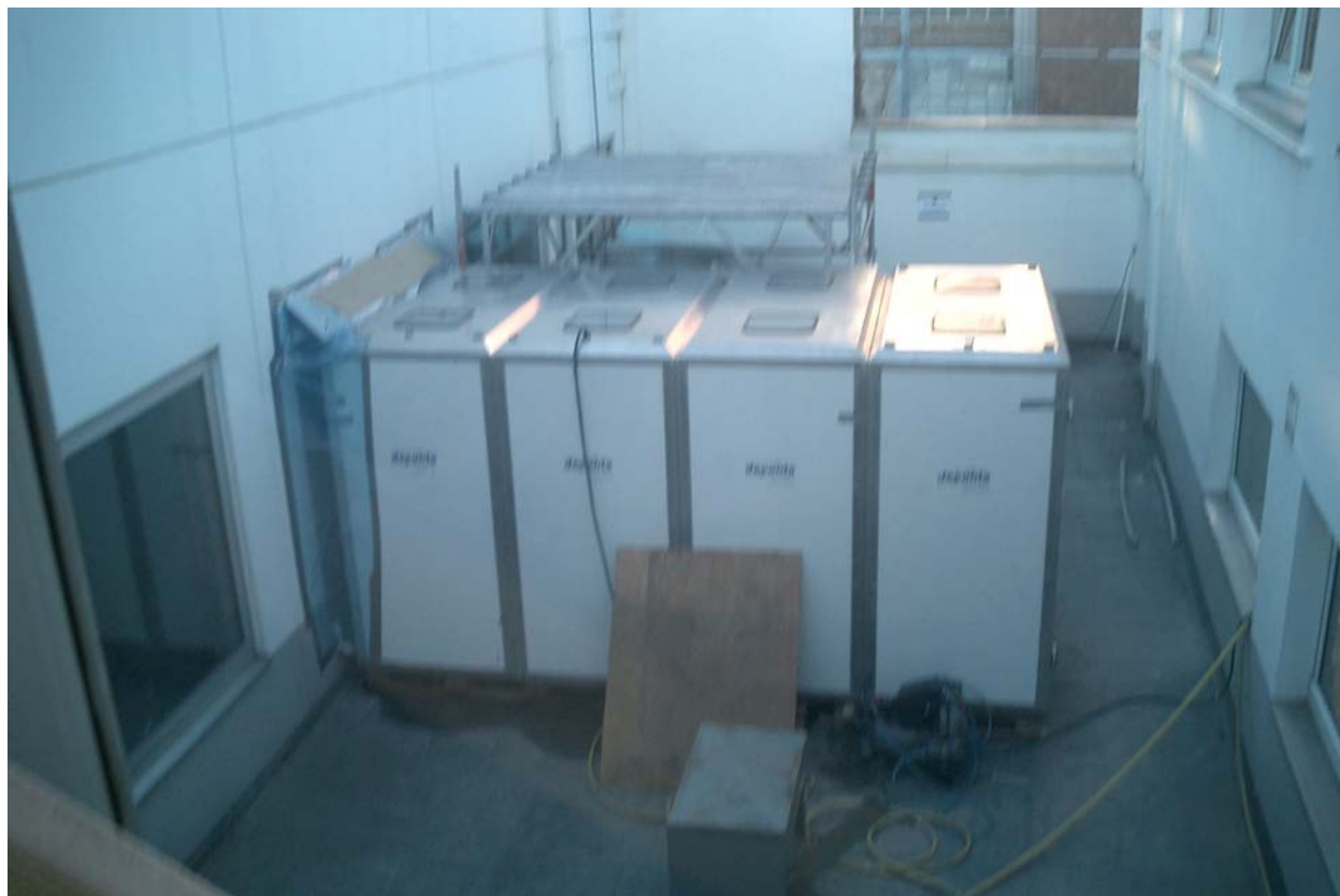
Materialschleuse im Innenhof eines Bürokomplexes
