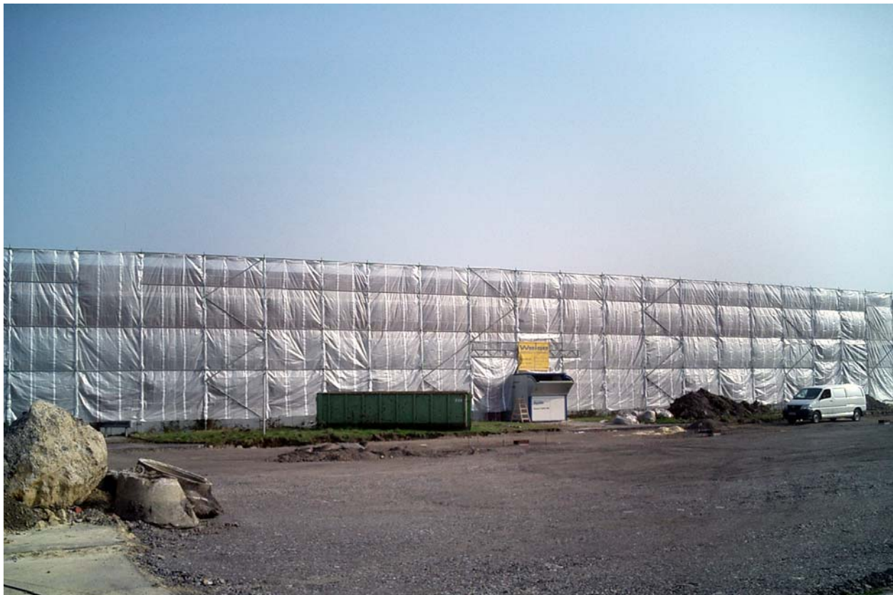
Kompletteinhausung einer Industriehalle mit Unterdruck
