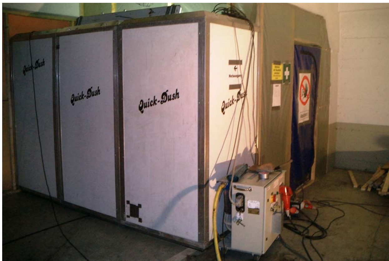
Personalschleuse mit Wassermanagement inkl. Vorraum
